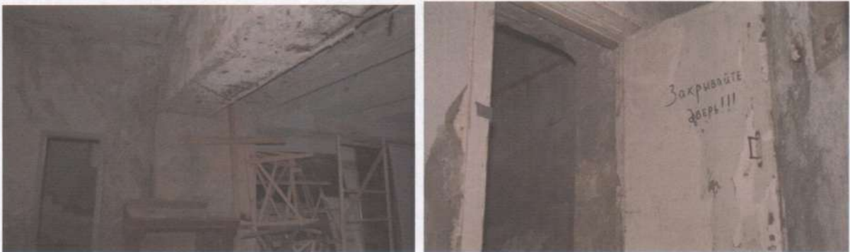
Фото 13, 14. Підвал. Технічні приміщення. Без необхідної гідроізоляції у вологих умовах протягом десятиліть корозія бетону та арматури, всі столярні вироби набухли, гниють, двері не закриваються.
