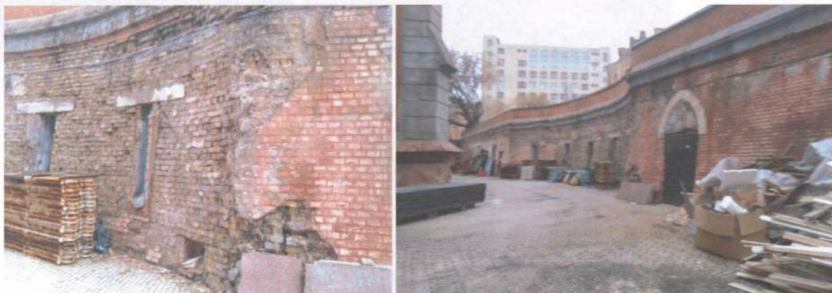
Фото 2,3. Технічні приміщення. Фото фасаду та конструкцій допоміжних приміщень радянської забудови свідчить про необхідність значних ремонтно-відновлювальних робіт для забезпечення нормальних умов їх функціонування.
