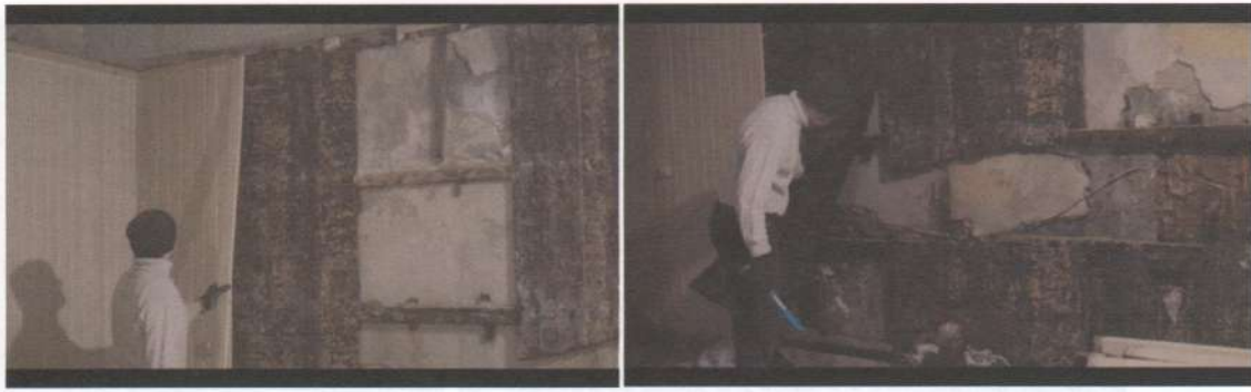
Фото 11, 12. Підвал. Технічні приміщення. Демонтована вагонна МДФ. У вологих умовах сліди затікання, без вентиляції шари плісняви на стінах, корозія бетону та арматури.
