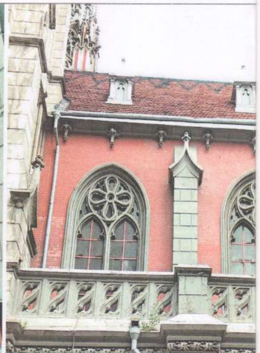
Південний трансепт (західний фасад). Недостатня жорсткість віконних вікон. Необхідно застосовувати прокати рам у єдину просторову каркасну навантаженість, зменшення переміщень.
