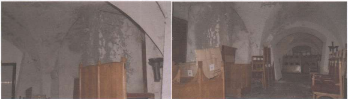
Фото 3, 4. Підвал. Приміщення гардеробу . У вологих умовах без вентиляції стіни вкриті шарами плісняви, штукатурка та оздоблення потріщали та осипаються.
