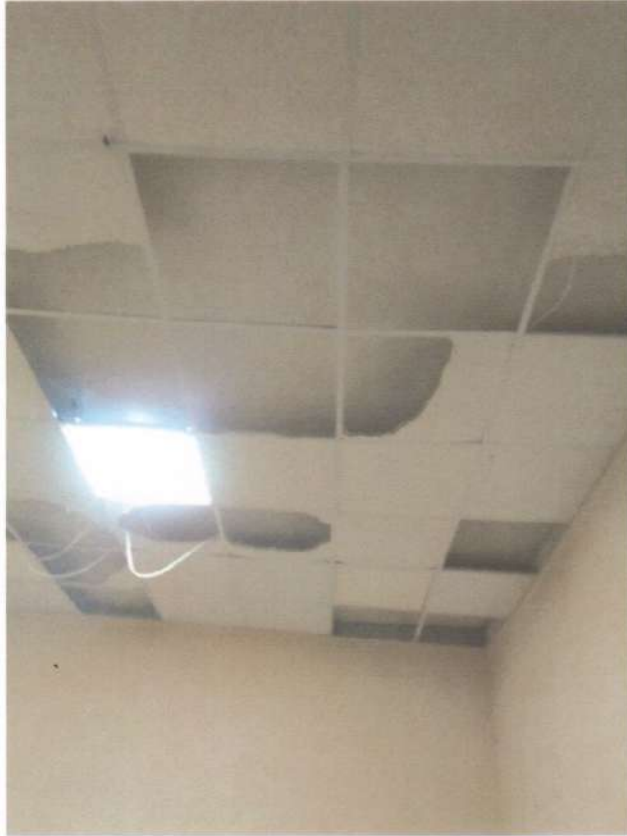
Фото 14. Підвал. Стан стелі прибудованого приміщення - потребує заміни.
