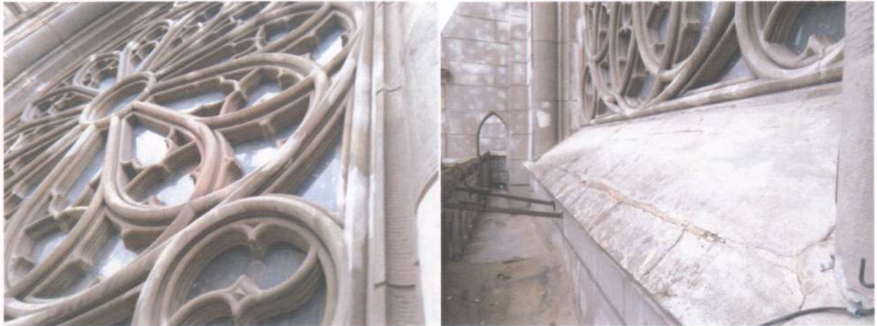
Фото 12, 13. В тріщинах скло вітража та каркас вікна над входом до храму. Величезне вітражне кругле вікно - «троянда» вже давно зазнає руйнувань та потребує негайних ремонтних та реставраційних робіт.
