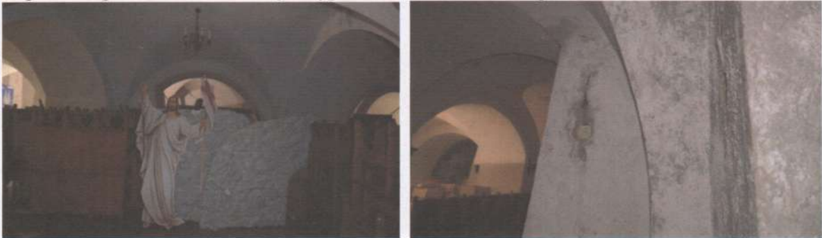
Фото 5, 6. Підвал. Приміщення гардеробу . У вологих умовах без вентиляції стіни вкриті шарами плісняви, штукатурка та оздоблення потріщали та осипаються.
