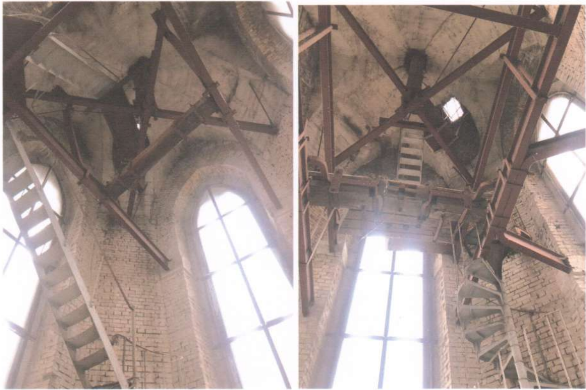
Фото 10, 11. Покрівля, дах. Металеві конструкції покрівлі потребують очистки від корозії та надійного антикорозійного покриття.
