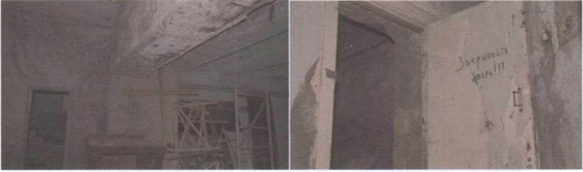
Фото 1, 2. Підвал. Технічні приміщення. Без необхідної гідроізоляції у вологих умовах протягом десятиліть корозія бетону та арматури, всі столярні вироби набухли, гниють, двері не закриваються.
