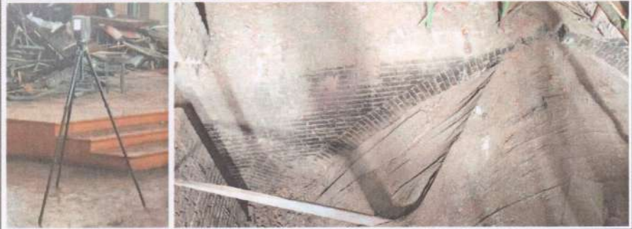
Приміщення горища. Прохідні галереї з площадками вантажопідійомних лебідок на рівні металевих кроквяних ферм. Виконання 3d-сканування периметра об'єкта для фіксації деформації основних несучих і огорожувальних конструкцій. Вигляд арочних і купольних склепінь базилики на горищі, під шаром утеплювача
