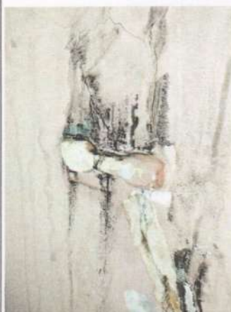
Словова клітина хорів. Розкриття вертикальних тріщин на спостережних маяках стіл. Деформації будівлі костелу тривають
