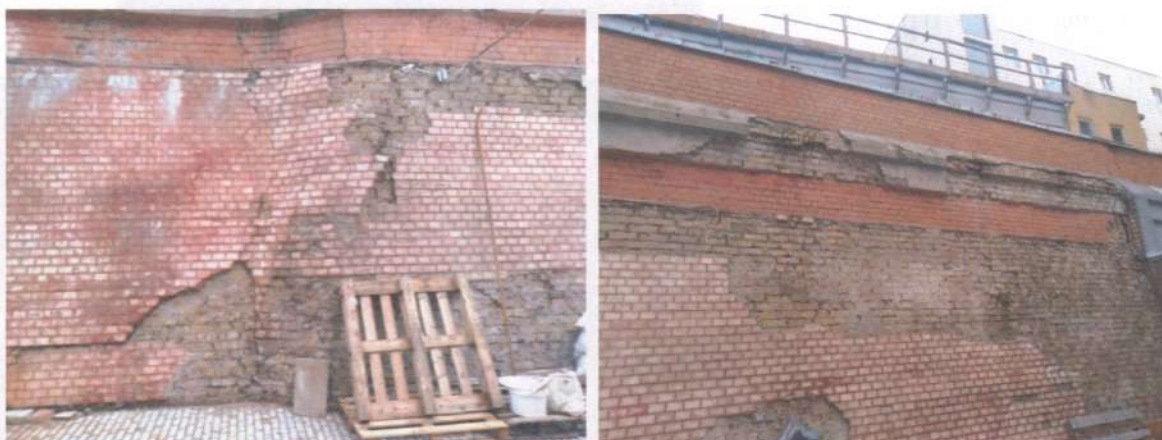
Фото 4, 5. Технічні приміщення. Фасади допоміжних приміщень мають незадовільний вигляд: потріскалося, обсіпалося облицювання плиткою, вивалилися куски цегли та карнизів. Практично всю поверхню фасадів та карнизи необхідно замінити новим оздобленням, влаштувати нову покрівлю з напуском для захисту від дії природних чинників (опадів та морозу).
