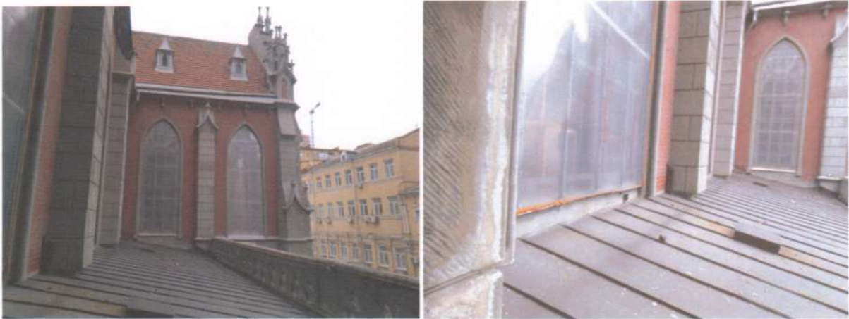
Фото 12, 13. Покрівля балконів другого поверху, а особливо, його огороження з тріщинами та корозією бетону і арматури, потребують капітального ремонту та реставрації, або повної заміни ідентичними за кольором і формою сучасними конструкціями.
