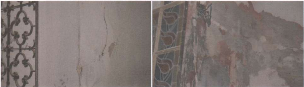
Фото 7, 8. Підвал. Технічні приміщення. Без вентиляції у вологих умовах протягом десятиліть корозія бетону, арматури та електропроводів. Пліснява, тріщини штукатурки, оздоблення та їх осипання.
