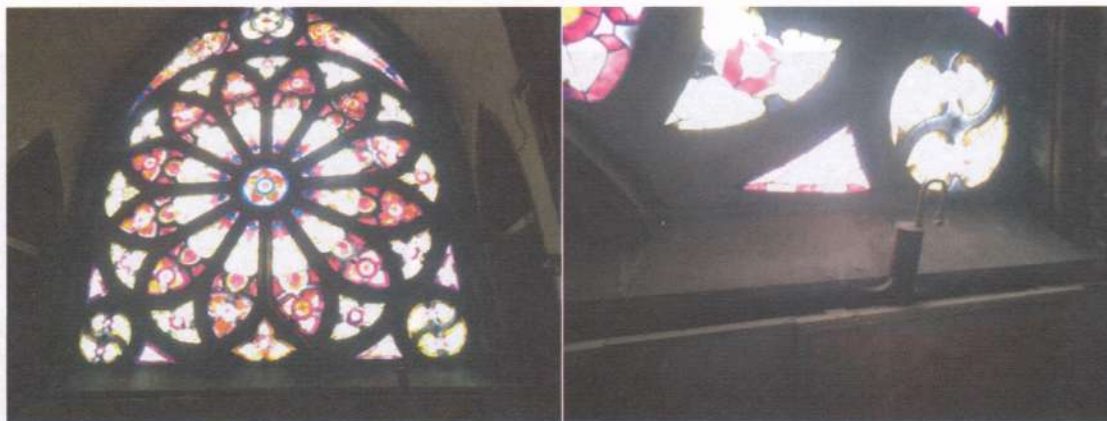
Фото 13, 14. Конструкції рам та скляних вітражів великої «троянди» мають тріщини і потребують особливої уваги та великих обсягів реставраційних робіт.
