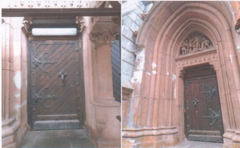
Фото 1, 2. . Вхідна група потребує капітального ремонту та реставрації.
