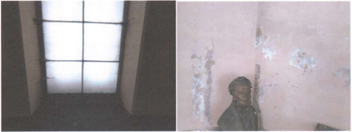
Фото 26, 27. Конструкції другого поверху. Стан конструкцій вікон та їх оздоблення незадовільний і потребують повної реставрації.
