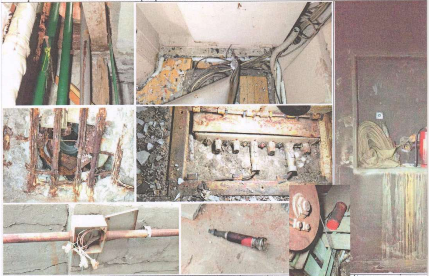
Стан інженерних мереж будівлі. Корозія трубопроводів в підвалі. Системи вентиляції. Корозія решітка вентканалу в надпідвальному перекритті.
