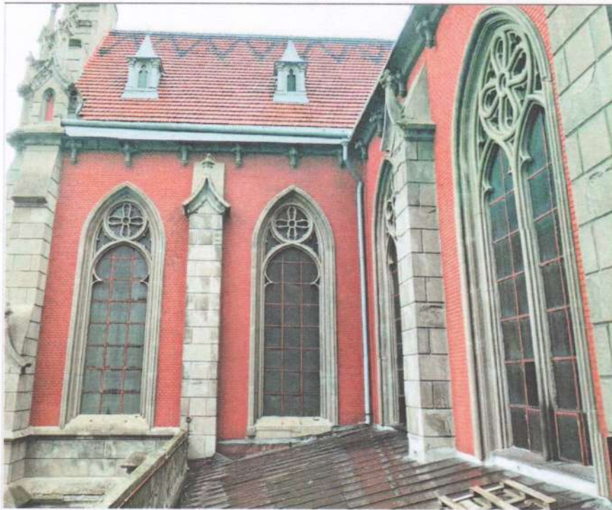
Північний трансепт (західний фасад) та галерея над північною навою. Вікна галереї 2-го яруса з нижніми слулками, що відкриваються та глухі вікна трансепта. Пойкодження віконних шибок. Деформація металевих рам. Сліди кіптяви та сажі вздовж тріщин та шприн.
