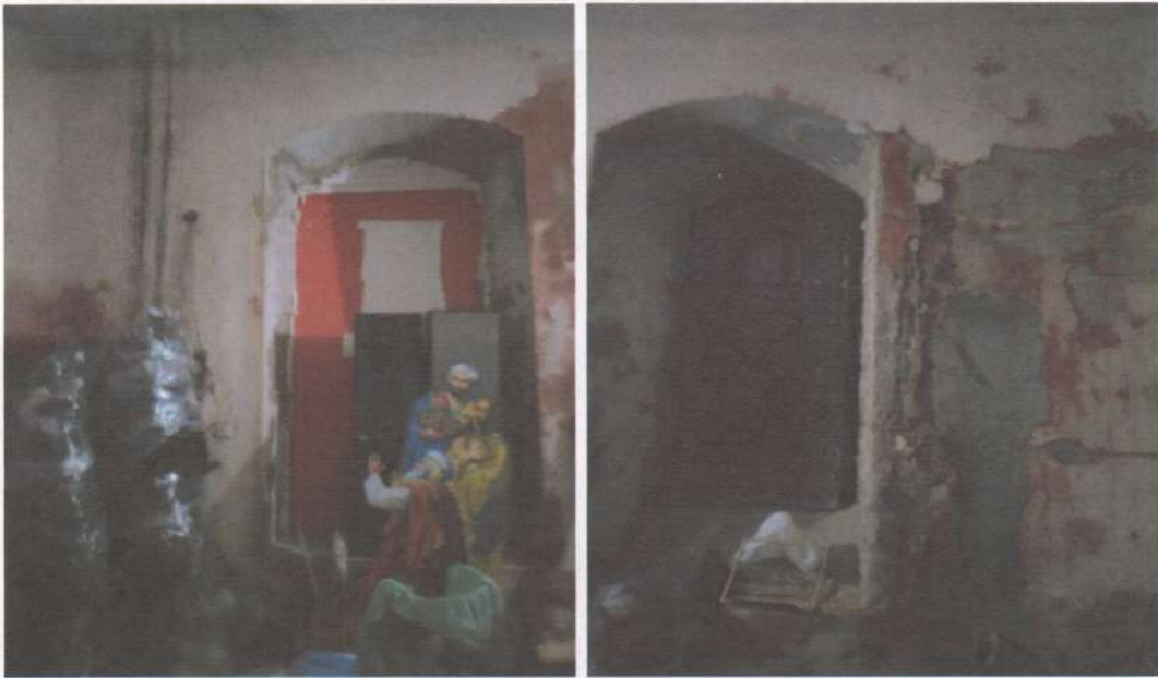
Фото 5,6. Підвал. Технічні приміщення під центральним вівтарем. У вологих умовах протягом десятиліть, корозія залізобетону, арматури, ел. проводів., руйнування і осипання штукатурки, відшарування оздоблення, на поверхні стін цвіль.
