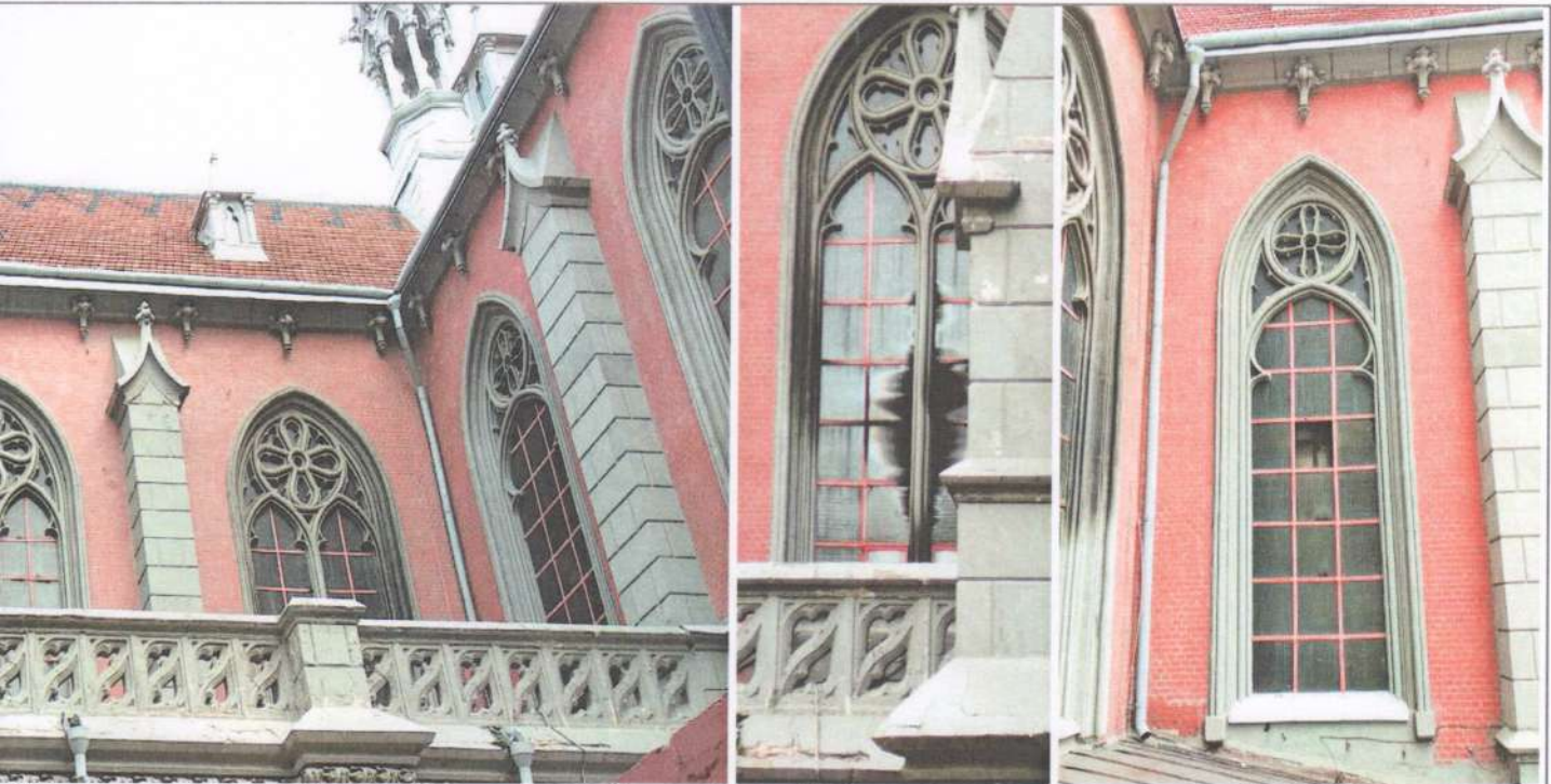
...до) та галерея. Вікна 2-го яруса центральної нави. ...рам з металевої стрічки (штрипса) з площини ...тний фасонний профіль або з'єднання роздільних ...структуру для спільного сприйняття вітрових ...деформації та пошкоджень скління
